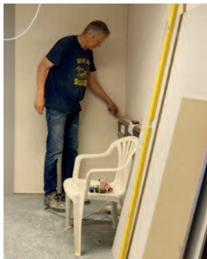
Karl Rædergård i aksjon.
