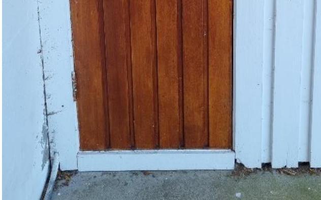
Figur 11 Oppkant ved inngangsdør til toalett
