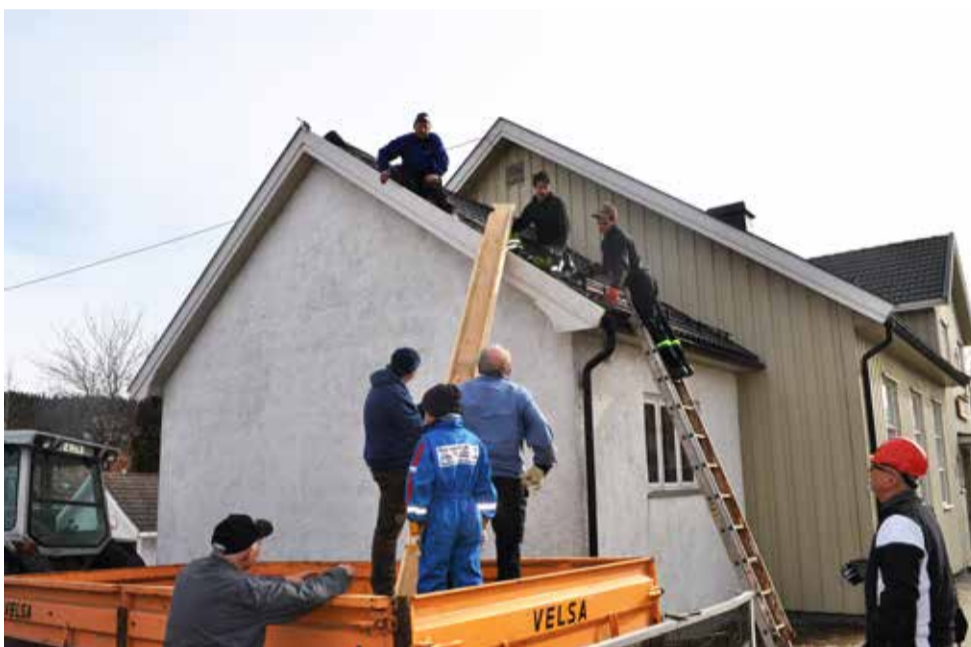
Unge og eldre bidro på byggstart. På taket: Johannes Martin Eriksen, Ole Martin Lien og Jens Olav Vaaler. På hengeren: Stig Magnus Lunde, Ivar Ånesland og med caps: Thoralf Dahl. Med hjelm: Trond Degnes. Ytterpanelen måtte også bort. Med mange frivillige hender, får man gjort mye på en dugnadsdag.
