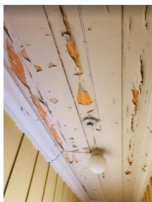
Vannskade i taket over galleritrappa
