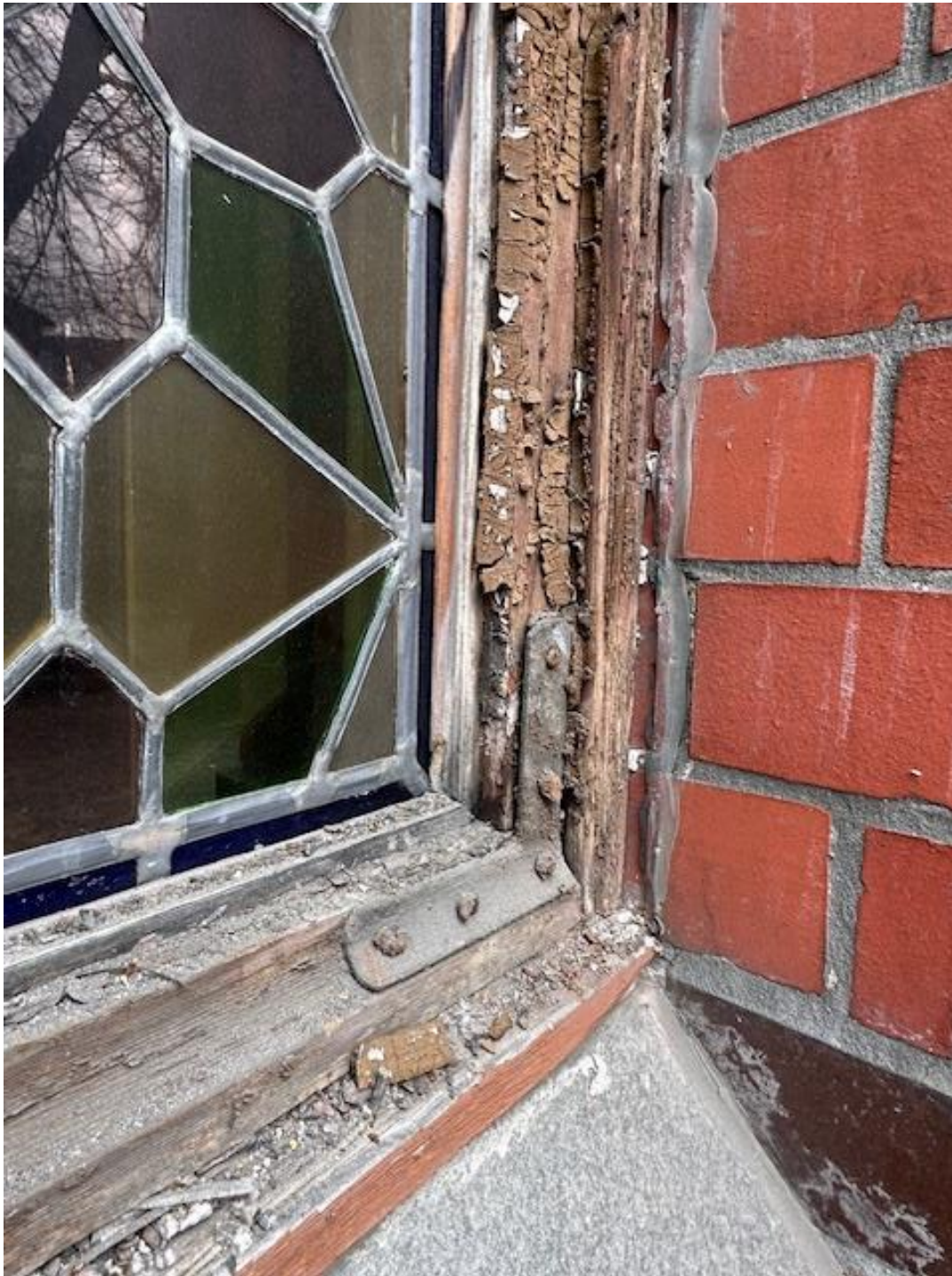
Bildet viser vindu nr. Ø 109, råteskader. Har stått i lang tid uten glass i utvendig varevindu. I høyre billedkant rester av silikon som har tettet mellom beskyttelsesglass og murverk.
