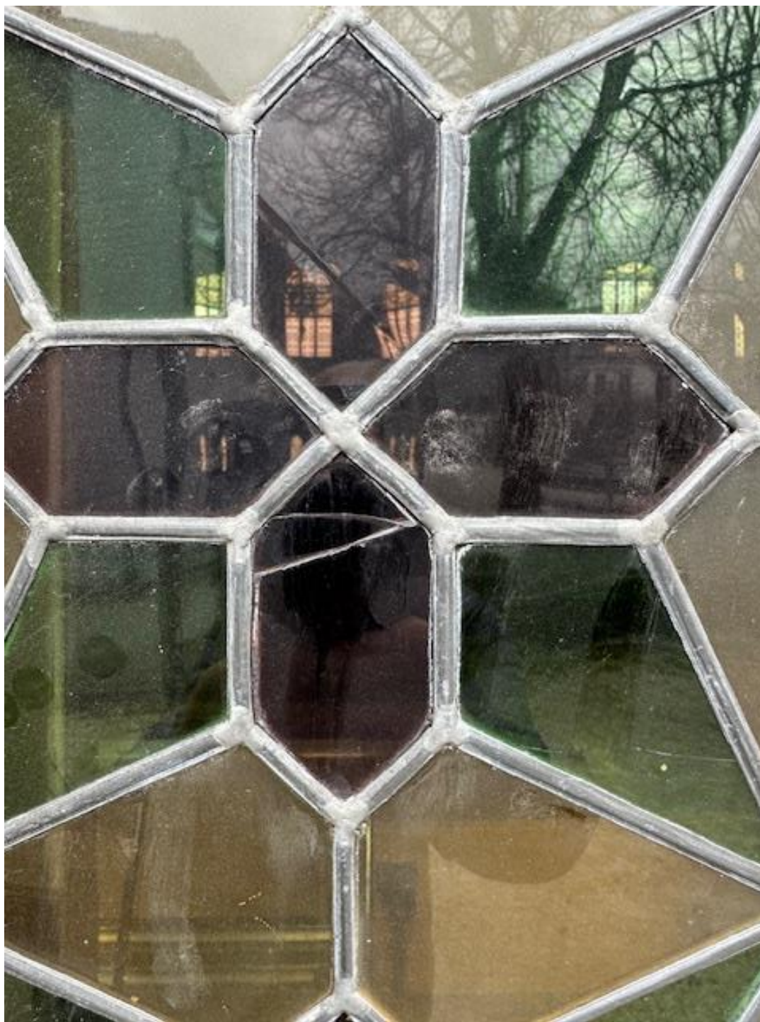
Vindu nr. Ø 201 Store utbøyinger der glasset sprekker og er på vei ut av blyprofilen p.g.a. utbøyingene.
