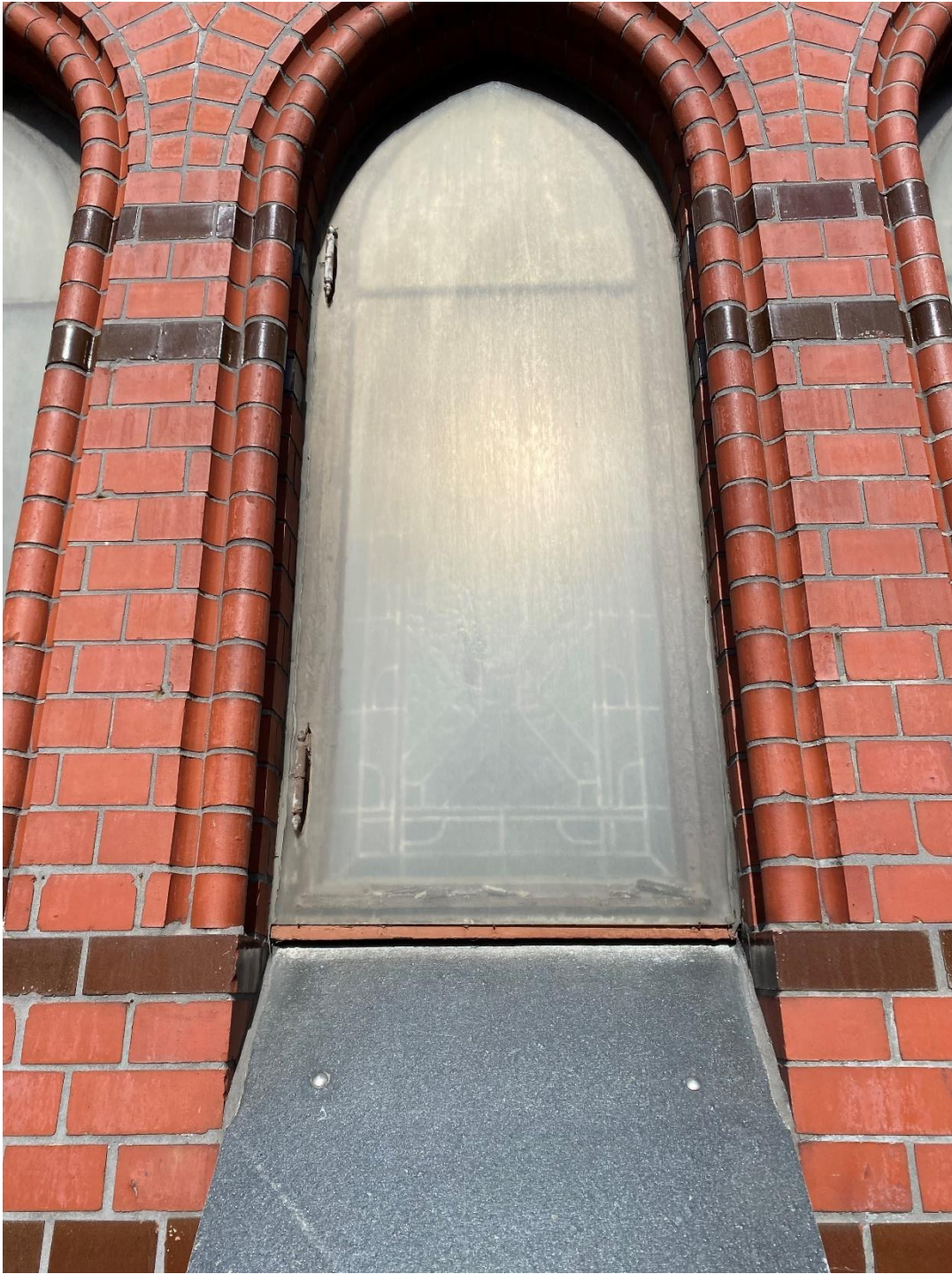
Vind S 110. Korrodert utvendig beskyttelsesglass.
