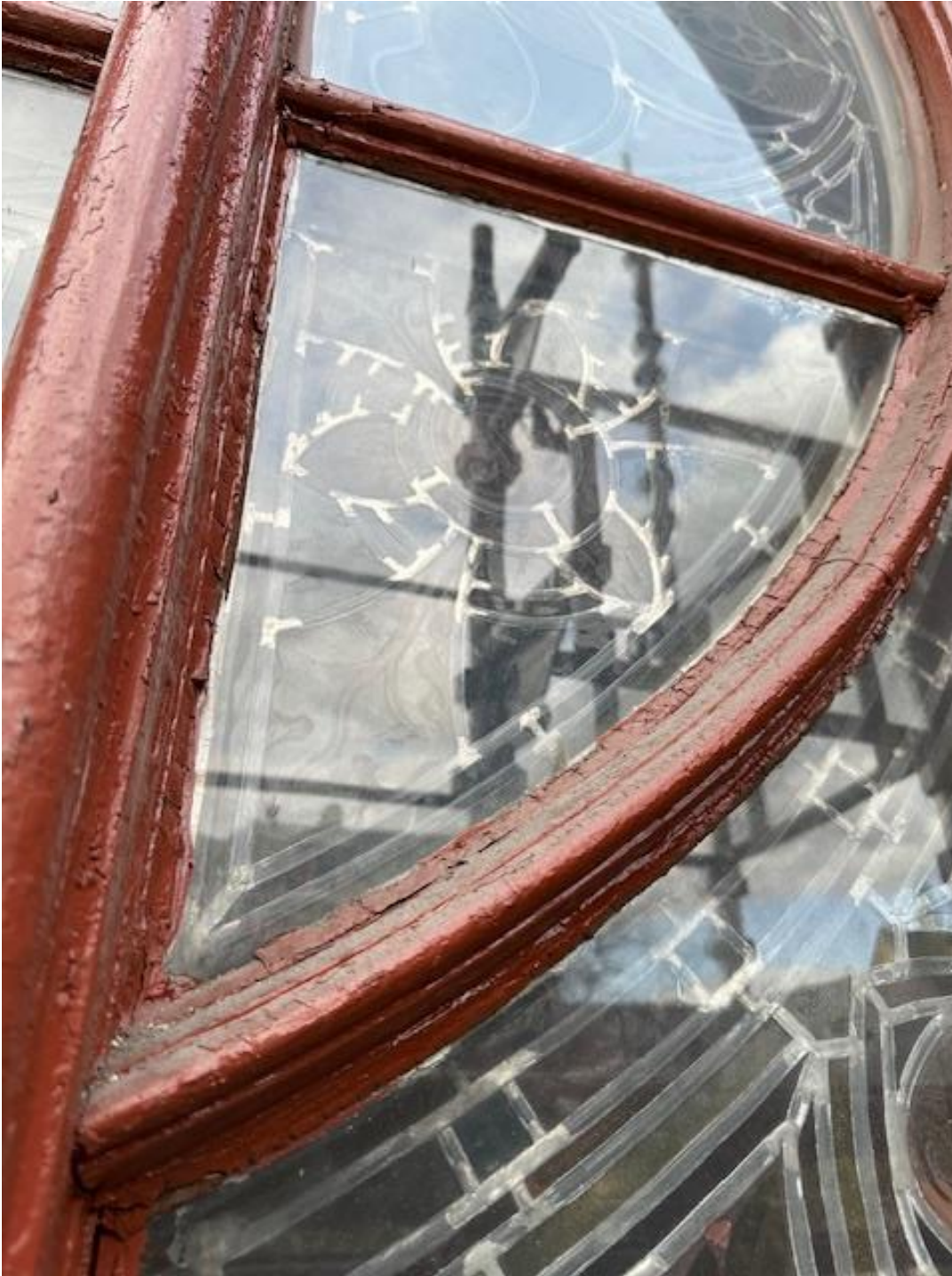
Vindu nr. V 207. Glasset i senter på bilde ser ut til å være gjenoppbygget. Loddinger avviker fra originale loddinger med sammenhengende «gater av tinn». Utvendige kittfalsler er supplert med diverse fugemasse.
