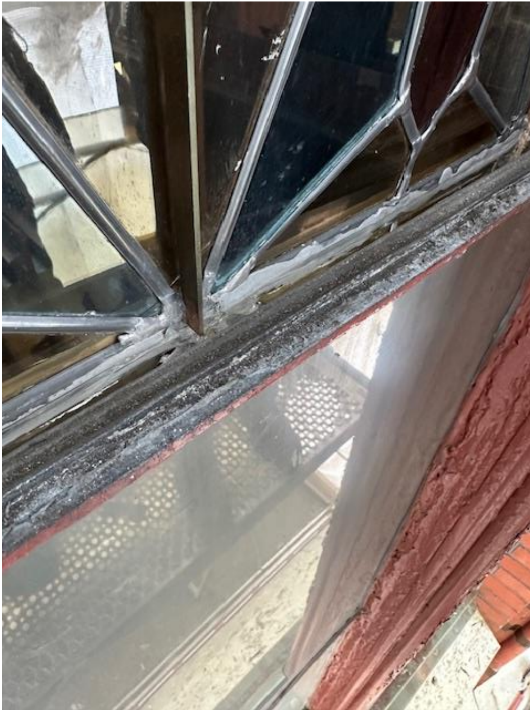
Vindu nr. Ø 207. Det er klint på eddiksyrebasert silikon for montasje og skjøting mellom blyglassene. Vareglass som er demontert på bilde av 3mm plexiglass var også montert med fugemasse. Nedre del av bildet viser sterkt korrodert vareglass i plexiglass. Også her er det uoriginale avstivere på blyglasset.
