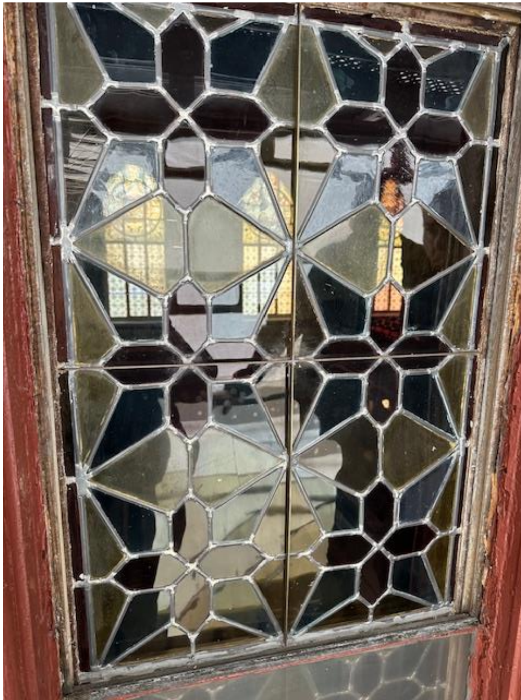
Vindu nr. Ø 207. Viser uoriginale avstivere. Plexiglass i varevindu er demontert. I nedre kant av bildet viser sterkt korrodert plexiglass montert i vareramme som også fremkommer på forrige bilde. Det er benyttet eddiksyrebasert silikon for montasje i horisontal sross av stål og skjøting mellom blyglassene.
