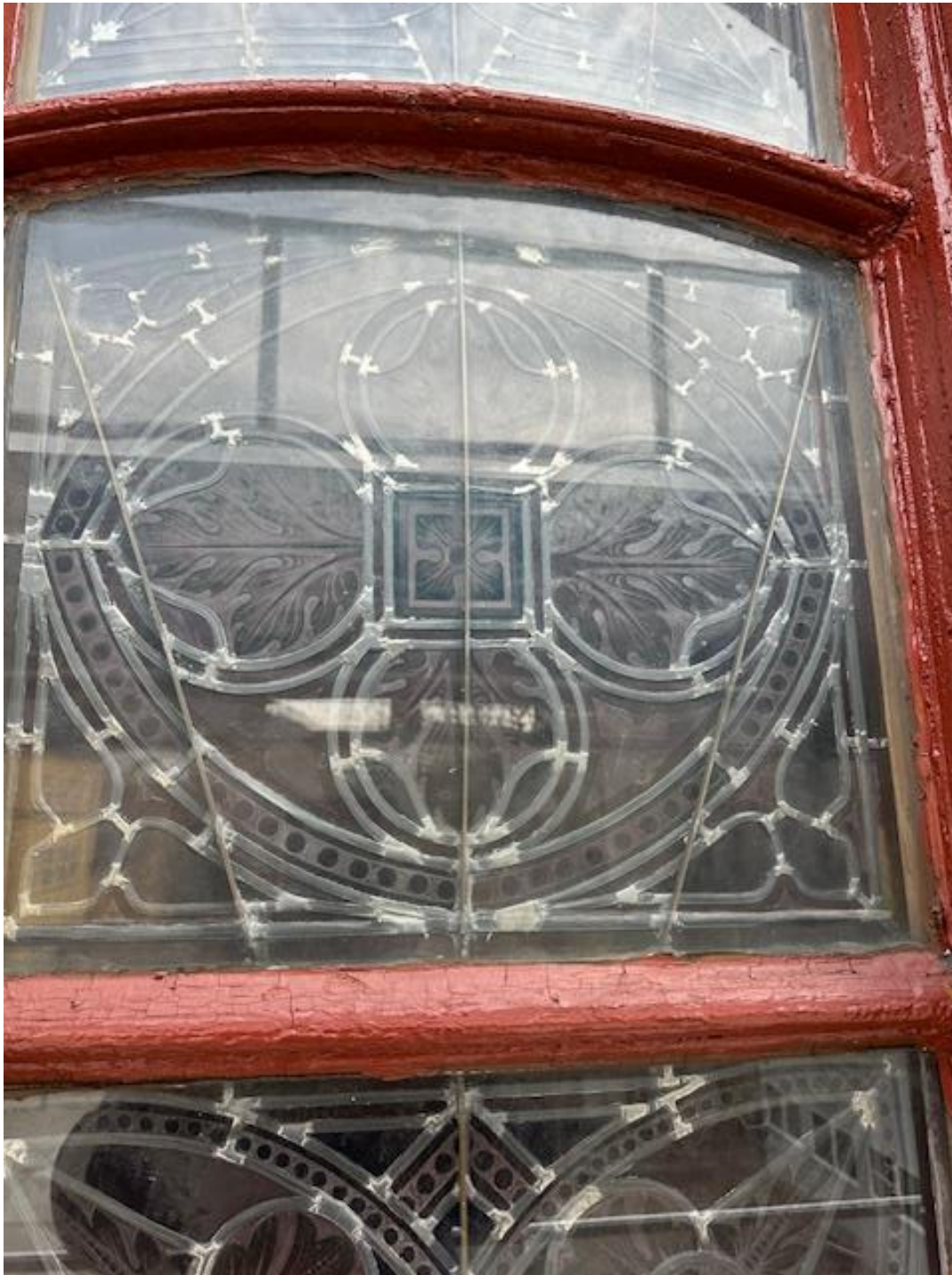
Vindu nr. S 203. Her er vinduet rehabilitert og det er montert uoriginale avstivere. Loddinger er særdeles slett utført. Kittfals på varevindu er delvis erstattet med fugemasse, sannsynligvis polyurethane. Det er ikke synlig kitt så blyvindueene er sannsynligvis ikke kittet og avstiverne i messing er da montert for å oppnå en viss stabilitet i blyglasset.
