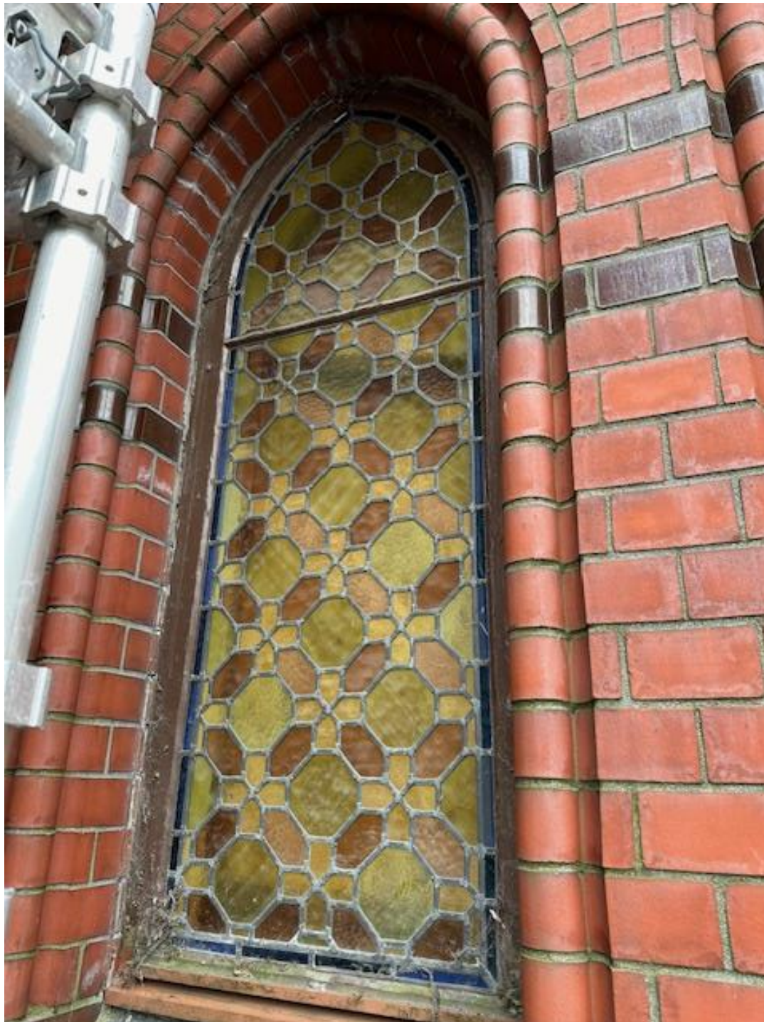
Bildet viser vindu nr. N 106 etter demontering av beskyttelsesglass i plast. Blyglasset er montert i ytterramme uten utvendig varevindu. Her virker treverk og blyglass til å være i vesentlig bedre forfatning.
