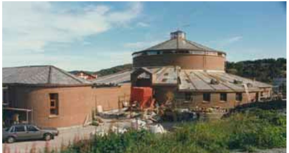
REKORDPROSJEKT: Fra byggearbeidet startet og til Åsane kirke sto klar til bruk gikk det i underkant av elleve måneder.
