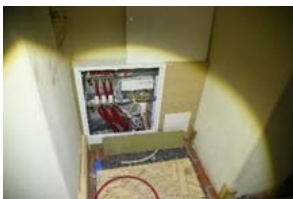
Vannbåren gulvvarme- fordelingskap bakerst i de gamle ovnsnisjene.
