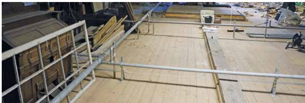
Sprinkelanlegg på loftet
