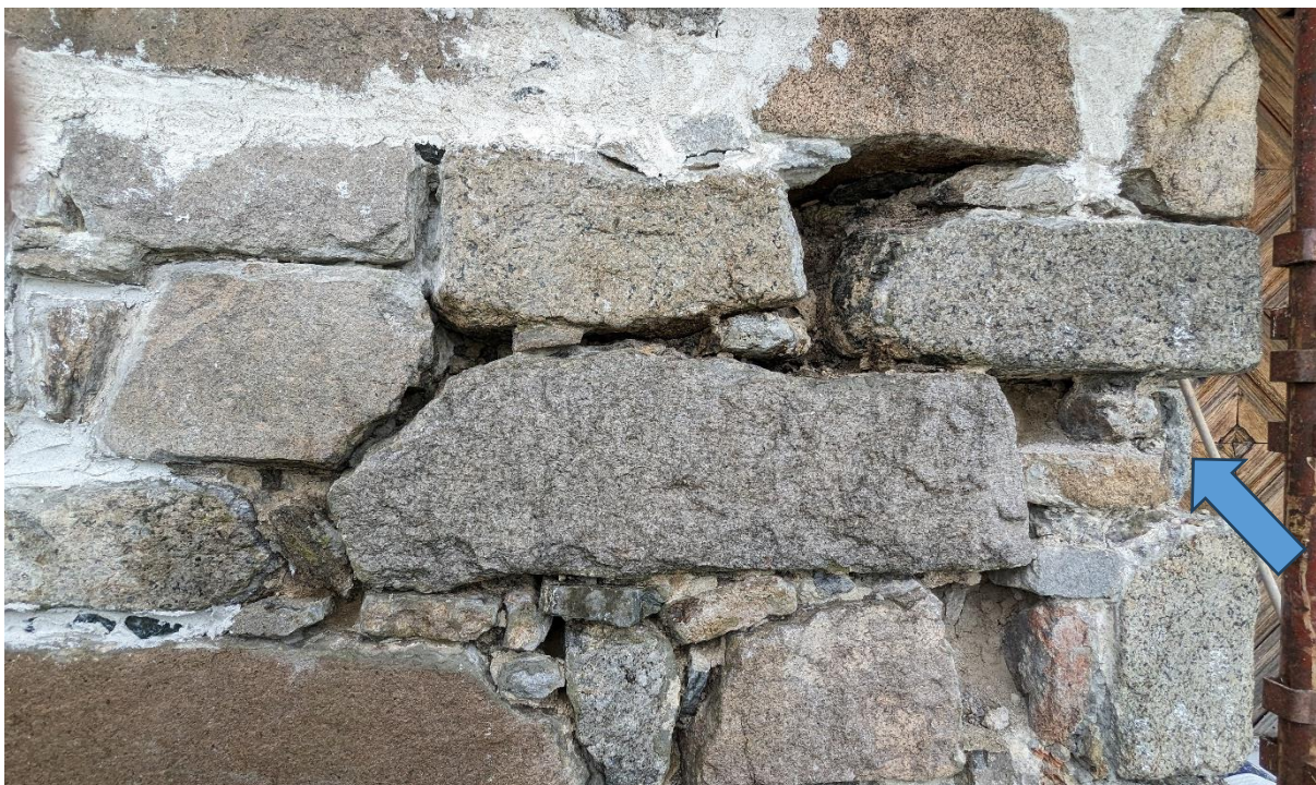
Figur 20: Deler av murverket rett vest for sørportalen. Her er det kalkmørtler som er annerledes enn middelaldermørtlene og partiet har trolig derfor blitt ganske sterkt reparert tidligere. Stein som ble erstattet ved restaureringen merket med pil
