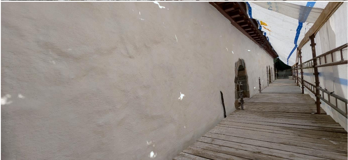
Figur 13: Fra øvre stillasetasje: Etter utkrasing av fuger, etter spekking og påføring av meddratte fuger og etter ferdig pussing, slemming og hvitning.
