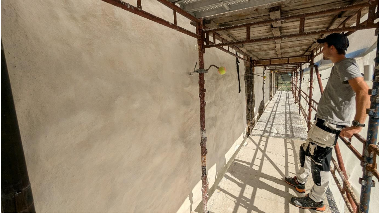
Figur 8: Martin Mannhart tar det ferdige arbeidet i andre stillasetasje i øyesyn. Vegg er fortsatt litt fuktig og lyset er for solgult gjennom stillasduken til å gi et helt korrekt inntrykk av fargetone på pussen.
