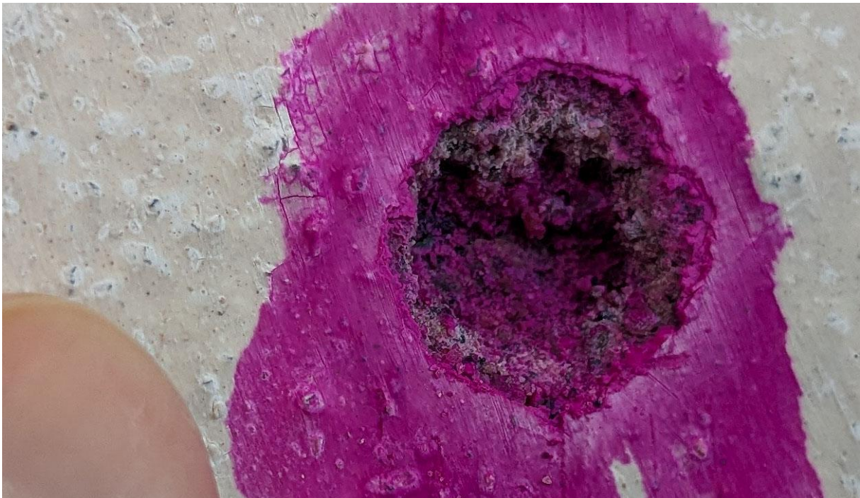
Figur 17: Test av karbonatisering med fenolftalein i den vestre delen, et par meter over bakken, umiddelbart etter at pussing er gjennomført (21.8.24). Her ser vi at det indre ikke er karbonatisert, så kommer et tynt felt i fugingen som har delvis karbonatisert og til sist tynn puss, slemming og hvitting som ikke har karbonatisert. Fingernegl som målestokk.
