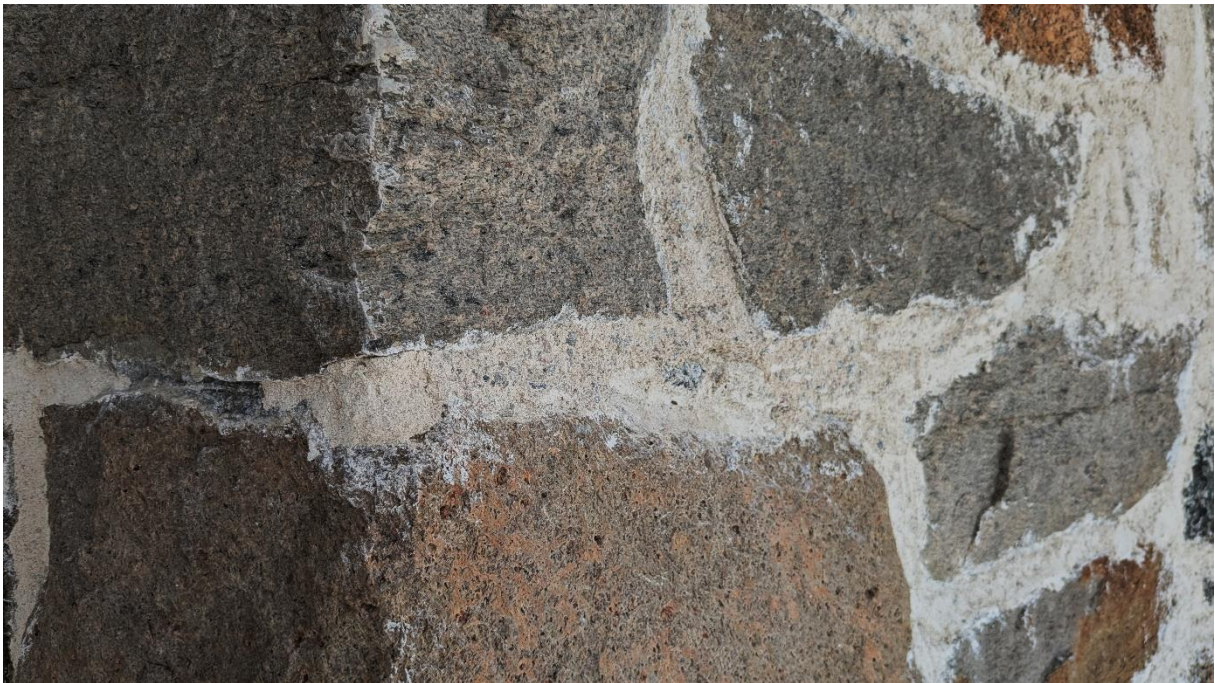
Figur 15: Ved første gangs spekking var det svært vanskelig å få til gode fuger i portalområdet. Fugene ble løse og oppsprukkede i det midlertidig tørre været. I august ble fugene utkraset og reparert.
