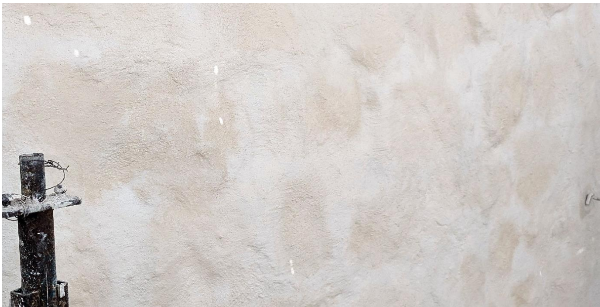
Figur 18: Gullige flekker over steinoverflater i øverste stillasetasje. Bilde fra 21. august.
