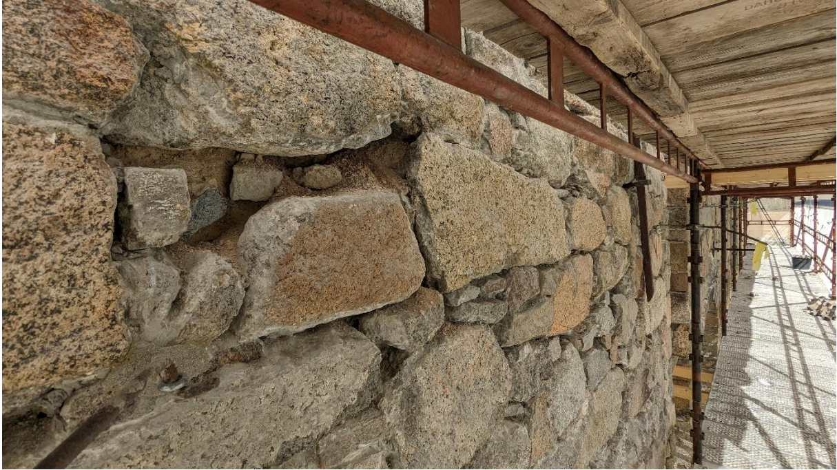
Figur 2: Inntrykk av dypt forvitrede fuger et stykke vest for det vestre vinduet på skipets sørvegg etter at sement ble hogd bort i 2023. Dette er i delen som ble forlenget i 1666.
