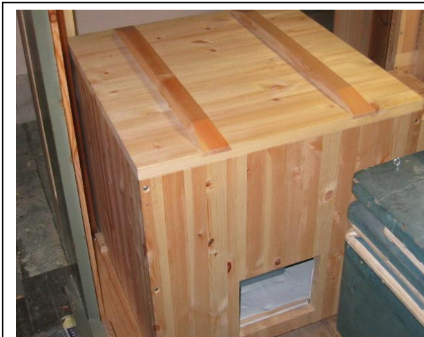
ny viftomotor monteres, den gamle vifta stod på kirkeloftet og trakk kald luft,
