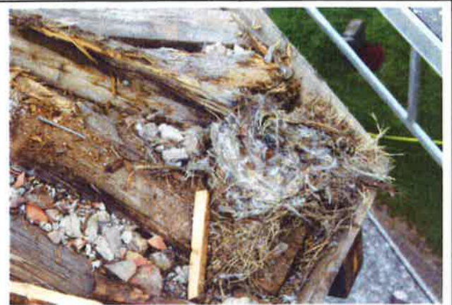
Reir og råte
