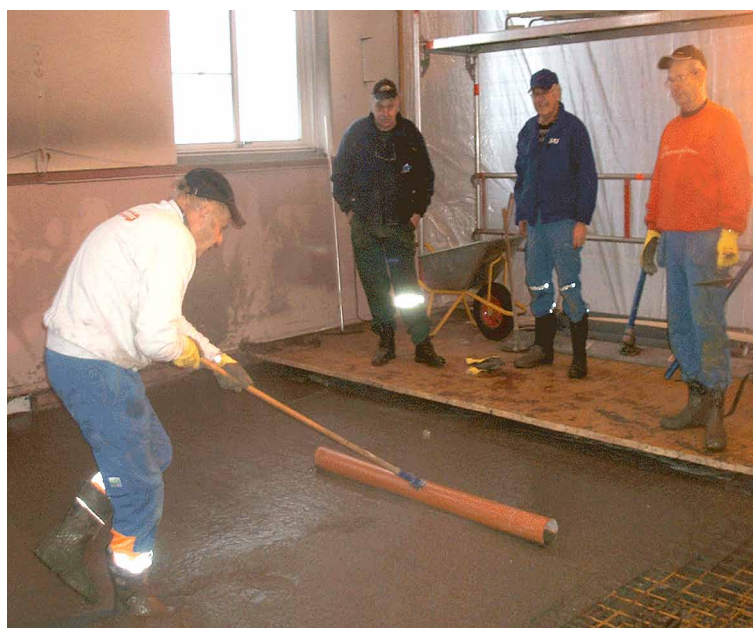
Over: Gulvet støpes. Legg merke til Kjell Røeds metode der han sletter støpen med et kloakkrør. Bak fra venstre: Nils Heien, Oddvar Sire og Bjørn Kampenhaus
