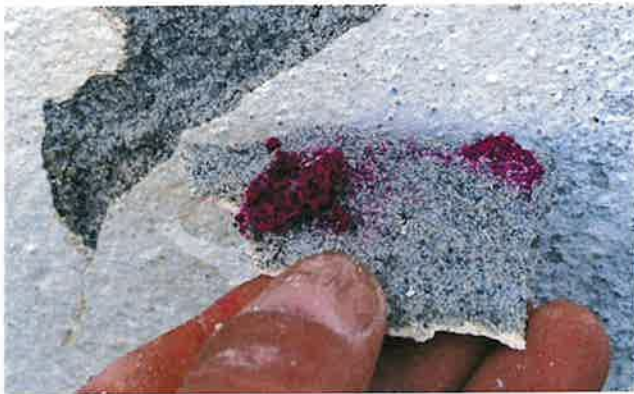
Noen dråper av kjemikaliet fenolftalein indikerer at den nye kalkpussen ikke er herdet/karbonatisert, her selv etter flere år. Dette betyr at pussen er følsom for frost. Årsaken er først og fremst for fuktige forhold og manglende tildekking første vinter etter påføring.
