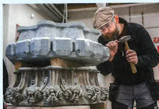
Bygghytta ved Nidaros Domkirkes Restaureringsarbeider har plass på UNESCOs liste over gode vernepraksiser for sin unike kompetanse innen tradisjonelle håndverk. Her er steinhugger Espen i aksjon.
