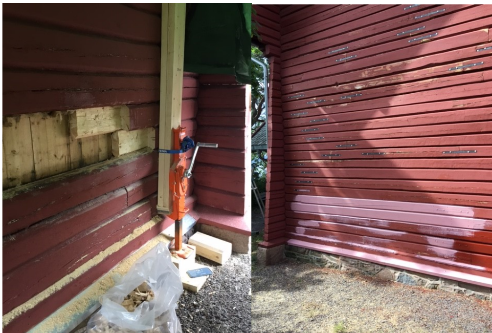
2 Bak endevegg er råtne stokker fjernet og nye felt inn. Bilde til høyre viser også metallband som bidrar til å styrke eldre skjøter. Nytt virke og vannbord er grunnet med egen maling.
