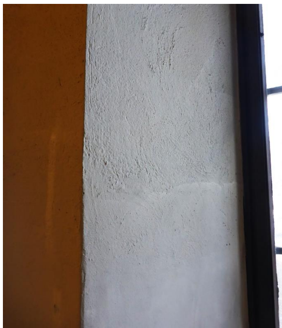
Bilde 6 Et av vindussmygene, der det var en overgang i pussoverflatene, noe som sees ekstra godt her. Alle veggene var likedan.
