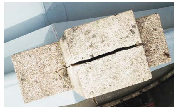
En drone har avslørt en sprekke i stenkorsset på Grefsen kapell. Foto: KfiO luftfoto.
