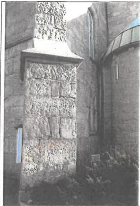
222: Setningsskader i strebebue mot tårn.
