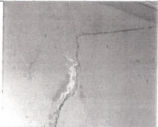
252: Sprekker i gulv ved tårn som følge av setningsskader.
