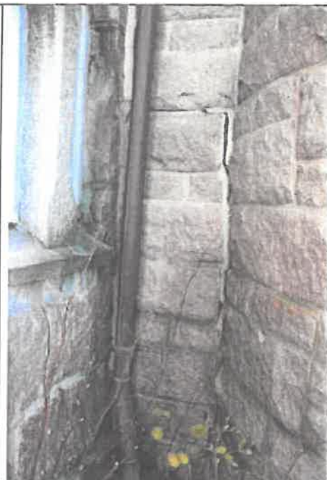
231(-2): Setningsskade mellom to bygningsdeler.
