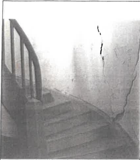
241: Riss og setningsskader i bærende innervegg i tårn.
