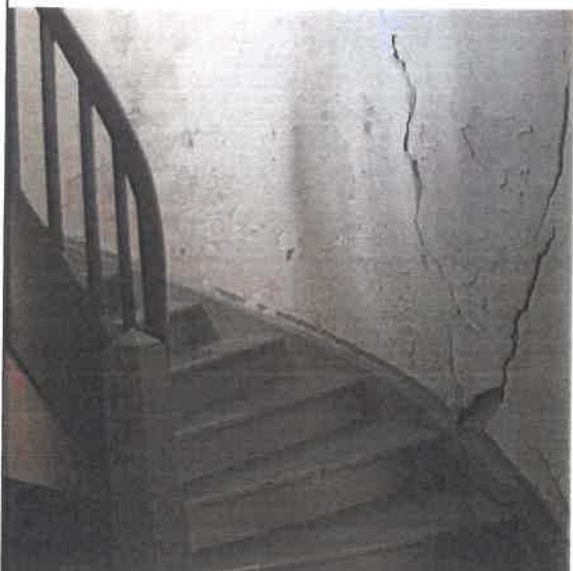
241: Riss og setningsskader i bærende innervegg i tårn.
