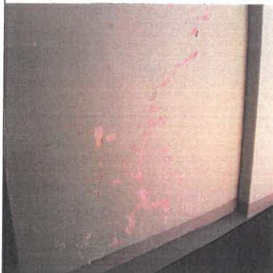
236: Felter med avskallet maling som følge av fukt og bruk av organisk maling.
