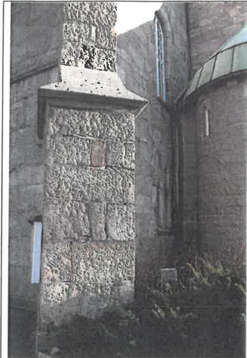
222: Setningsskader i strebebue mot tårn.
