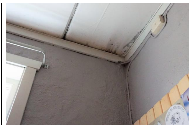
256: Luftlekkasje i kjeller nordvestre hjørne.
