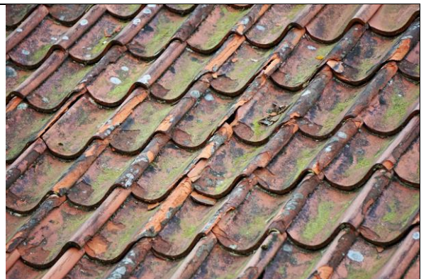
262-1: Sprukne takstein og begroing på tak.
