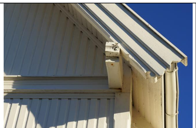
269: Ås på kirkens søndre side med påbegynnende råte.
