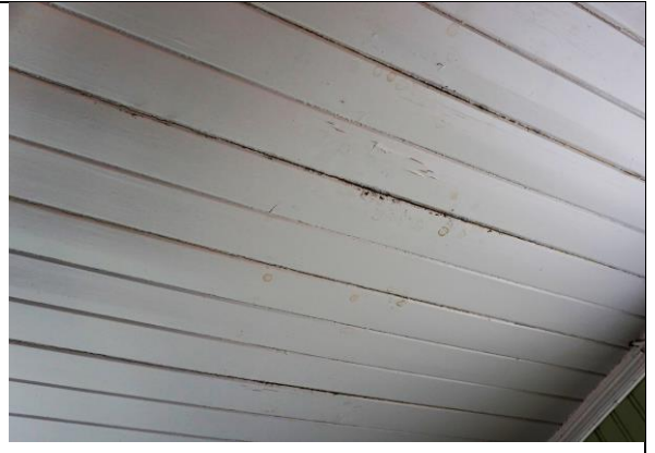
256: Merker etter fukt i himling i våpenhus.
