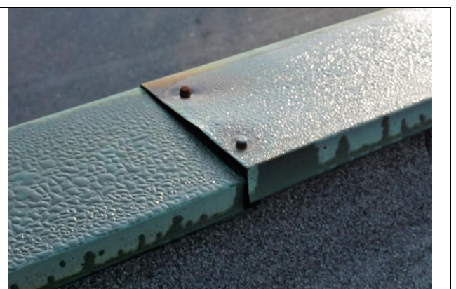
262-1: Løse beslag på gesims.
