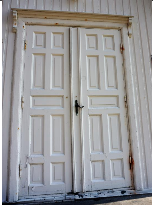
234-1: Tofløyet dør inn til våpenhus med rustne beslag og oppsprukken maling.
