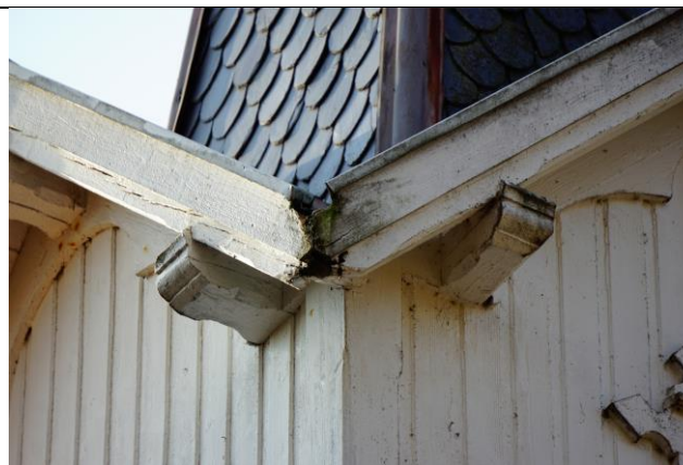
262-3: Råteskader på vindskier i tårn
