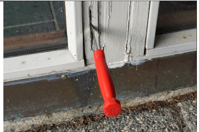
234-1: Råteskader i vinduskarm.
