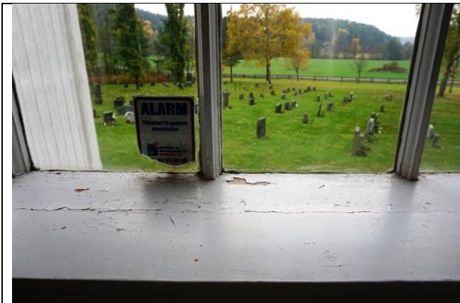
234-2: Sprukket maling i vinduskarm mot kirkegård.
