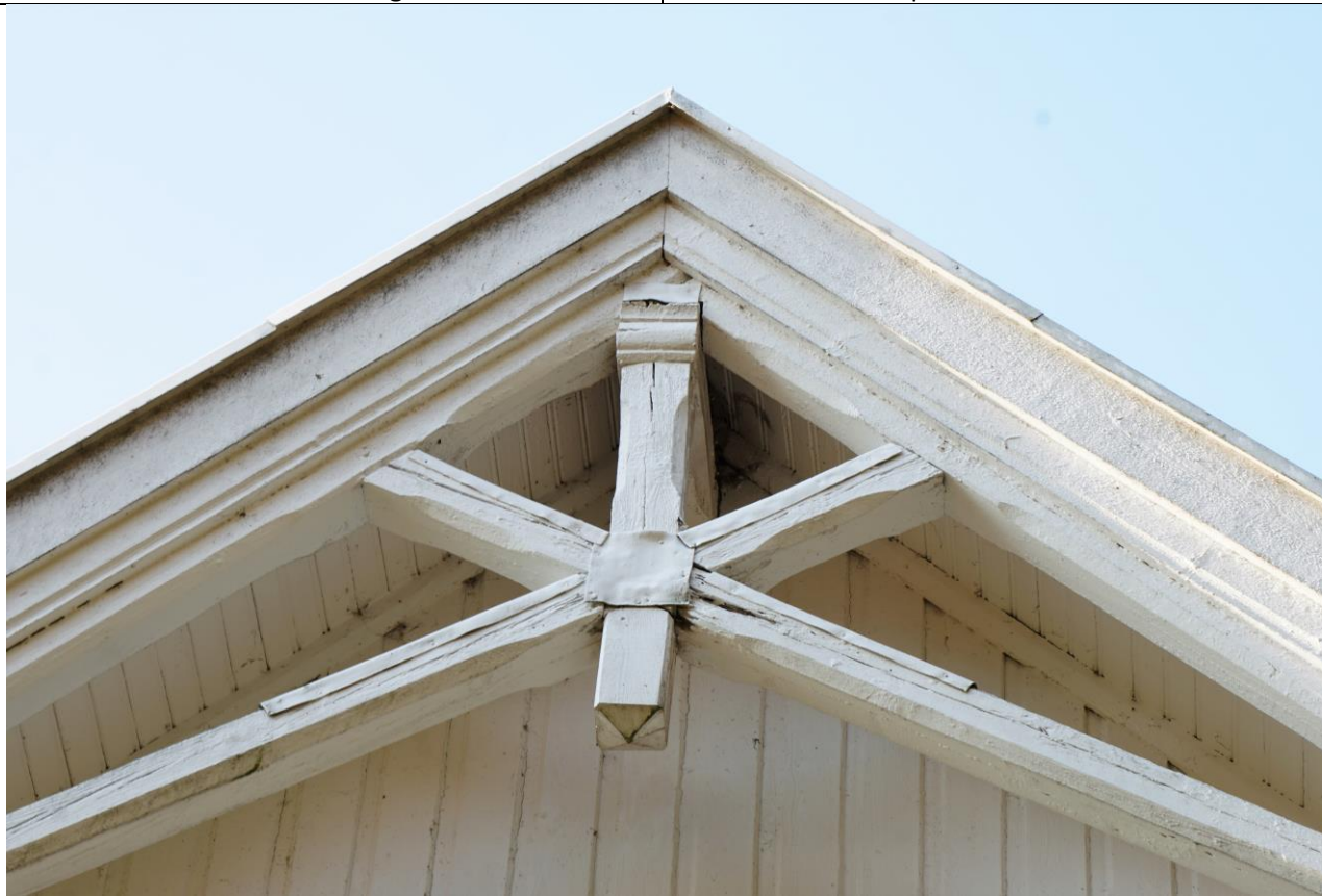
269: Saksekonstruksjon på østre side men råteskade.
