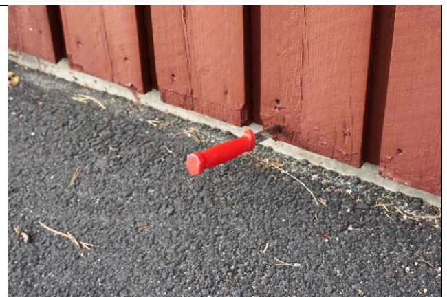
235: Råte i kledning på nordside.
