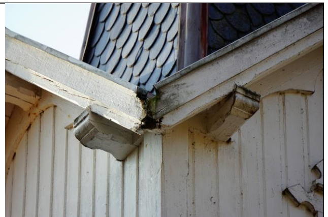
262-3: Råteskader på vindskier i tårn
