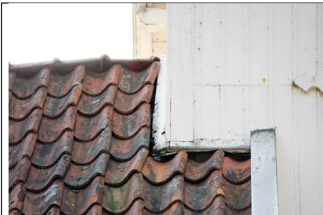
262-2. Vannbrett mellom tak og tårn.
