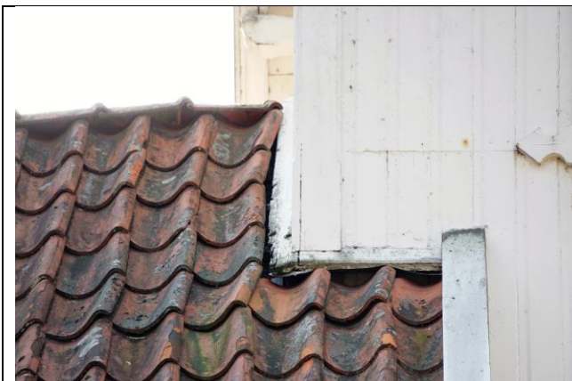
262-2. Vannbrett mellom tak og tårn.
