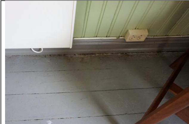
256: Gulvbord i våpenhus med ujevnheter.
