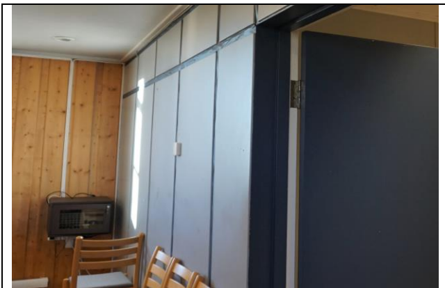
241-1: Vegg med boblete maling under galleri.
