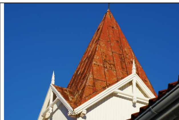
262: Takteking på tårn med tydelige skader.
