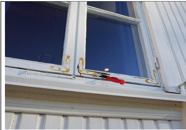
234-1: Vindu med råte på kirkens søndre side.
