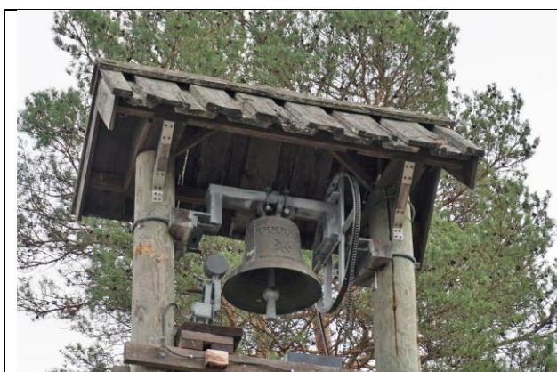
262-2: Tak på klokketårn har betydelige råteskader.
