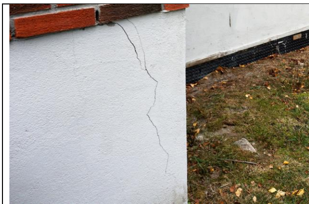
231: Riss i mur på kirkens sørvestre hjørne.
