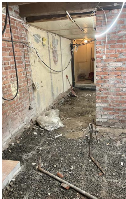
Kjellaren i Førde kyrkje er no tømt og gjort klart for varmesentral og nye toalett.
