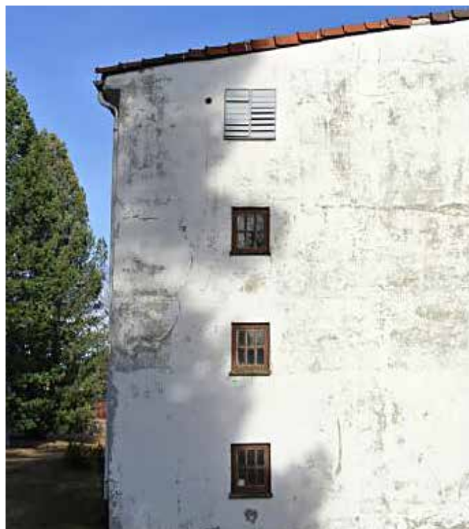
Sørveggen på Heimdal kirke med puss og betongskader. (Foto: Rambøll)
