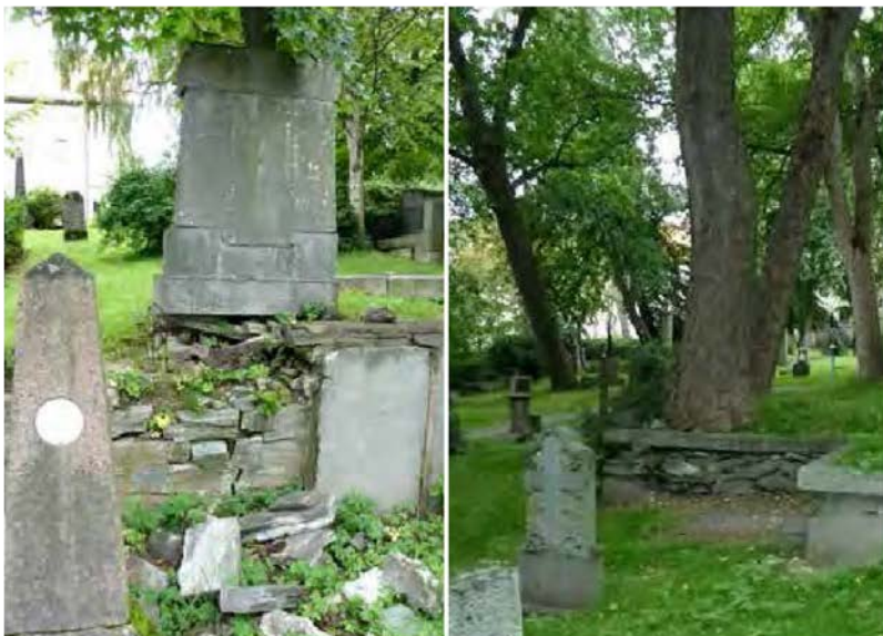
Her ser vi et eksempel på store trær som sprenger ut murer rundt et gravsted. Problemet gjelder også flere av støttemurene inne på kirkegården. (Foto: Trygve Jensen)
