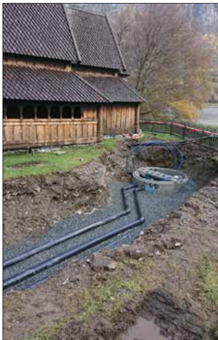
Under bakken ser det slik ut. Straum, vatn, telefon osv. til styring, brannvarsling og sløkkjing. Alle røyr skal inn i ein kum.
